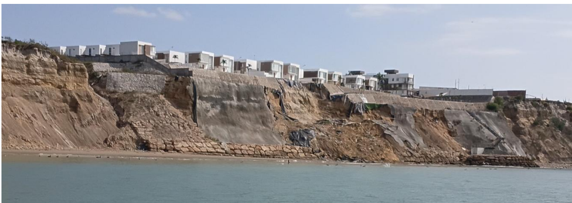
Proyectos inmobiliarios con serios problemas de erosión de taludes xiv .
